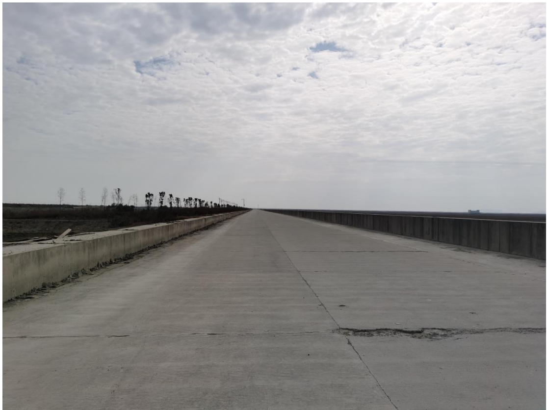
图 2.1-2b 出让海域南侧现状南堤
